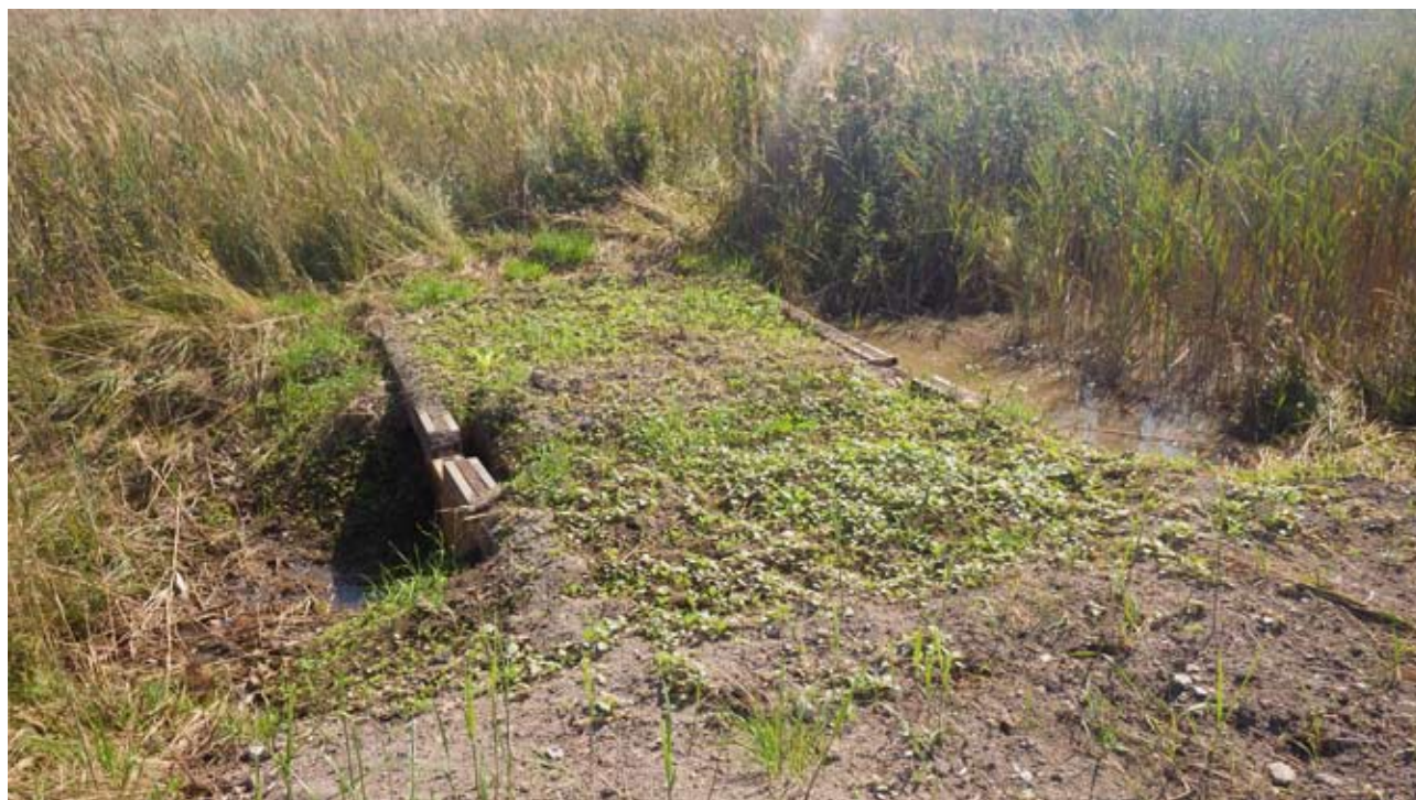
Fot. 3. Przepust dławiący (1 z 11 szt.) zainstalowanych w obiekcie Plebanka (fot. D. Horabik).
