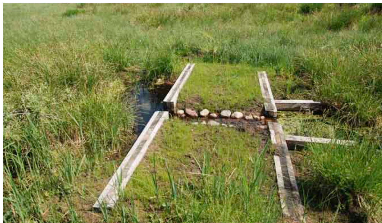
Fot. 59. Jedna z kilku zastawek wybudowanych w ramach projektu w obiekcie „Mielęcin-Bukowo” (fot. R. Stańko).
